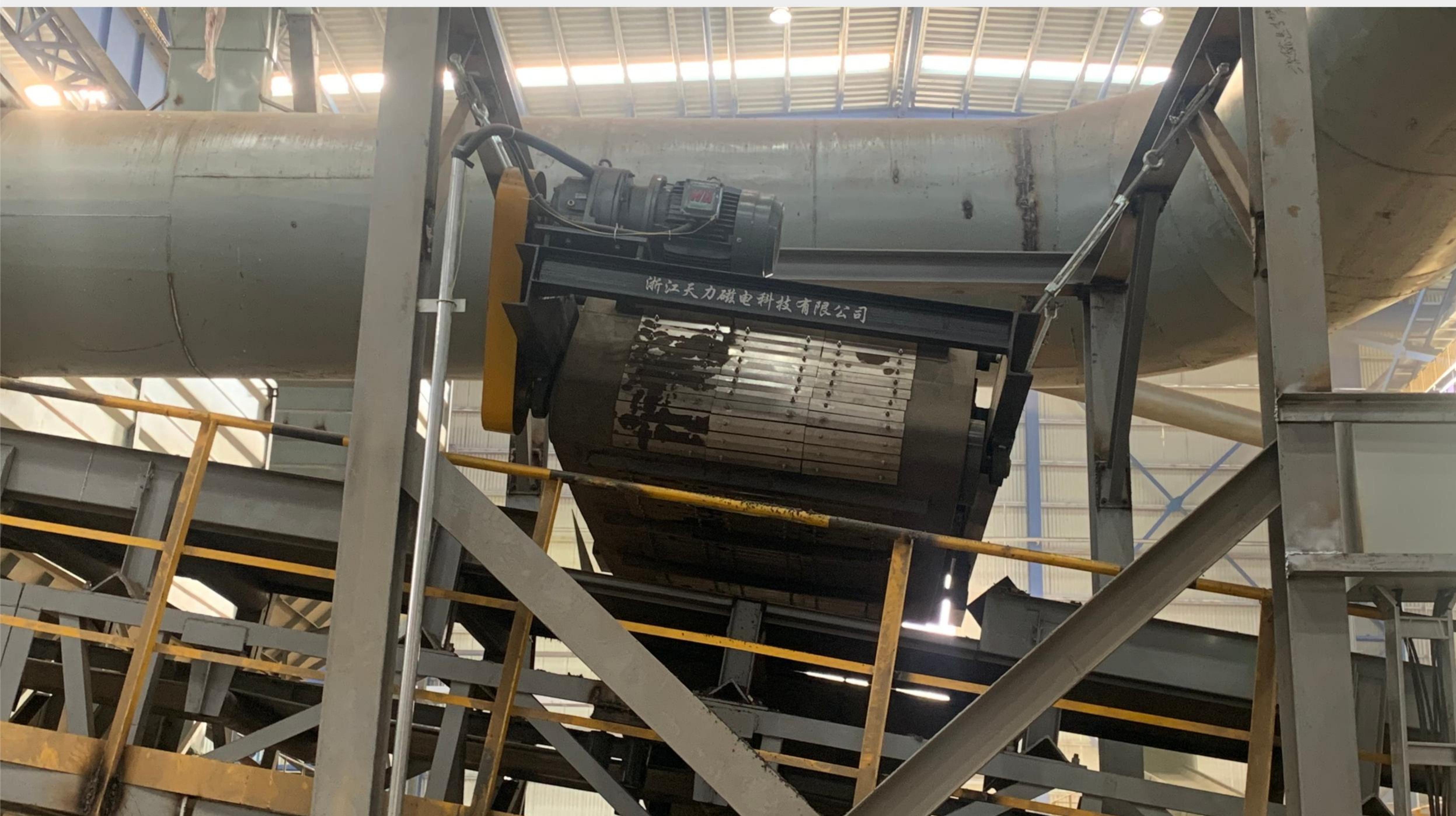
除铁器应用于废钢破碎线现场
